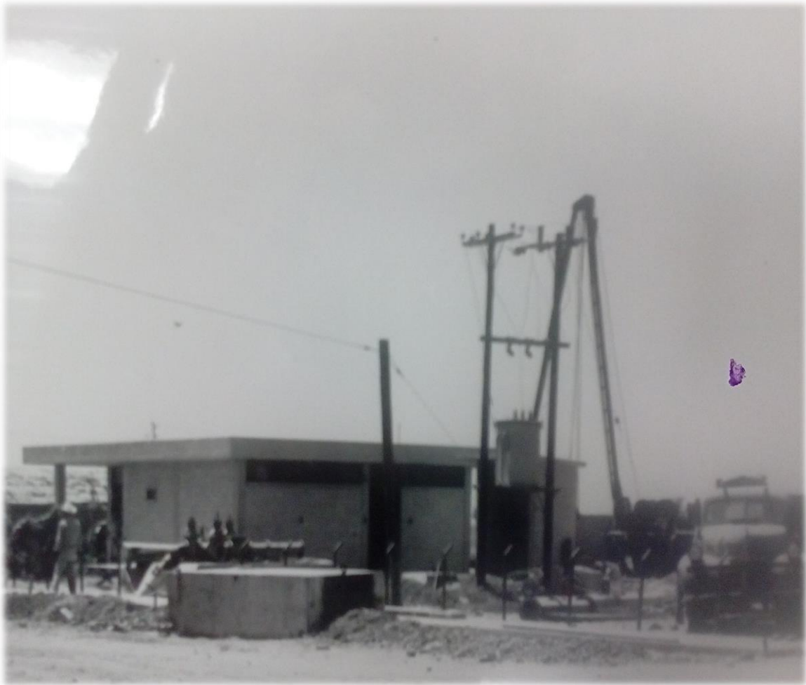
Fotografía 6. Casa de bombeo para agua potable en Pueblo Yaqui. Fuente: Lezama (ND/06/1965). Casa de bombeo para el agua potable de la población. Caja 1138, Exp. 34779, Año: 1965. Archivo Histórico del Agua. Colección Fotográfica. [A la derecha: un error del lente de la cámara].
