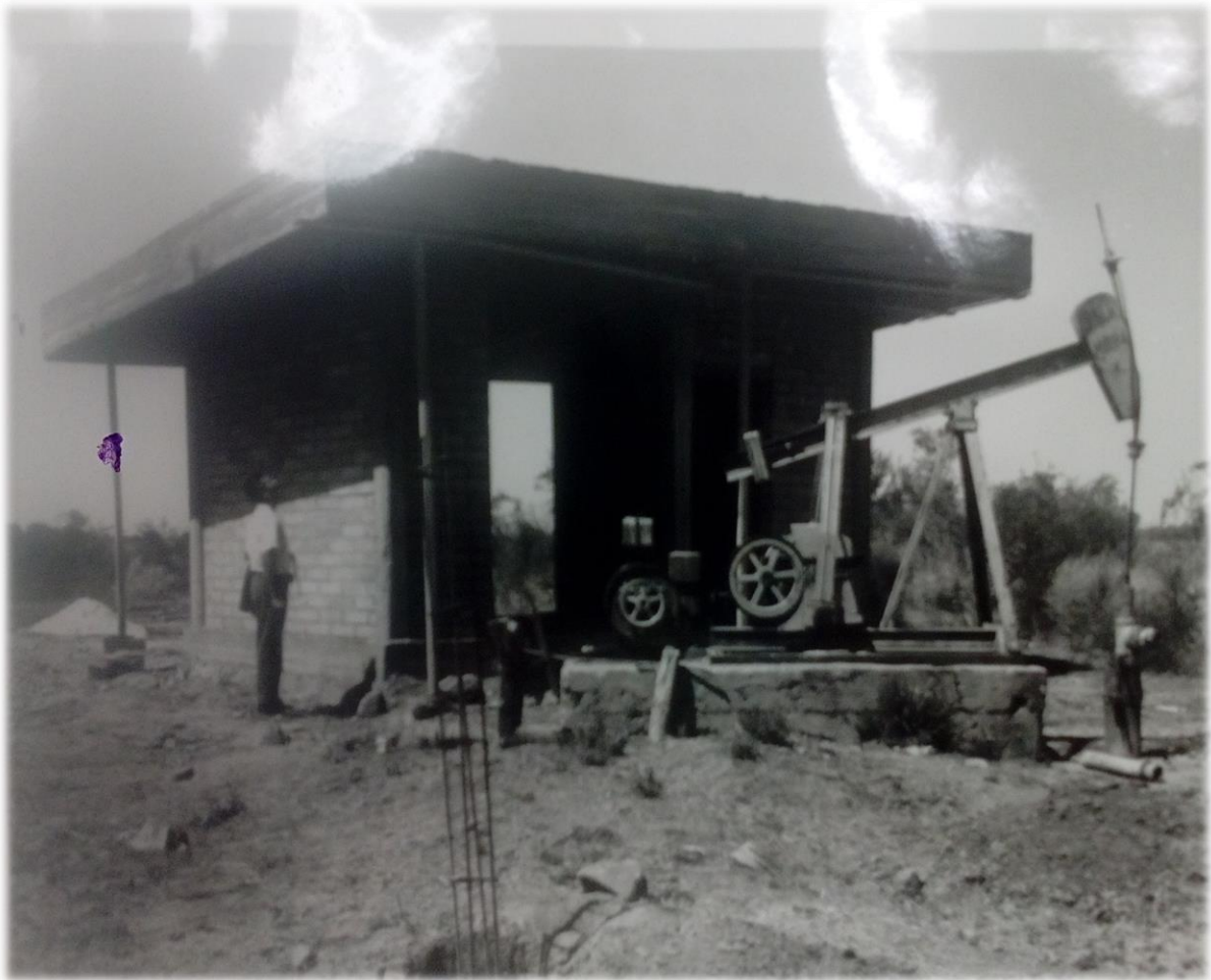
Fotografía 7. Caseta de cloración para agua potable en Ciudad Obregón, aunque no se especifica la ubicación exacta. Fuente: Hugo Mora (ND/04/1971). Caseta de cloración en construcción. Caja: 1251, Exp. 37939, Año: 1971. Archivo Histórico del Agua. Colección Fotográfica. [A la izquierda: un error del lente de la cámara].
