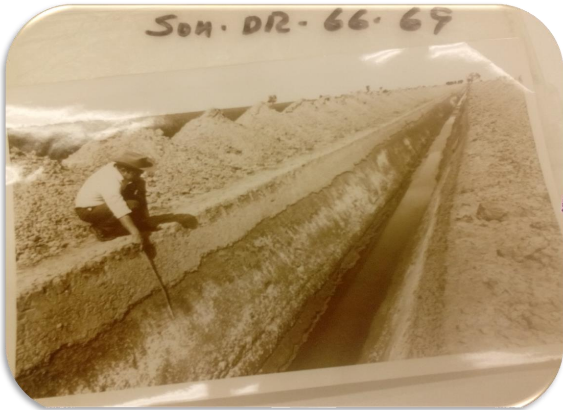
Fotografía 1. Panorámica de un canalero -trabajador- en obras de un canal de riego en el valle del Yaqui. Fuente: Tapia (ND/2/1969). Dren porcelano . Caja 47, Exp. 1092, Año: 1969. Archivo Histórico del Agua. Colección Fotográfica.
