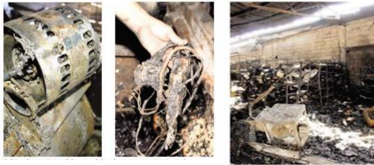
Ilustración 3. Imagen del cooler y del motor de cooler y derretimiento de conexiones eléctricas encontradas en la bodega de la Secretaría de Hacienda
