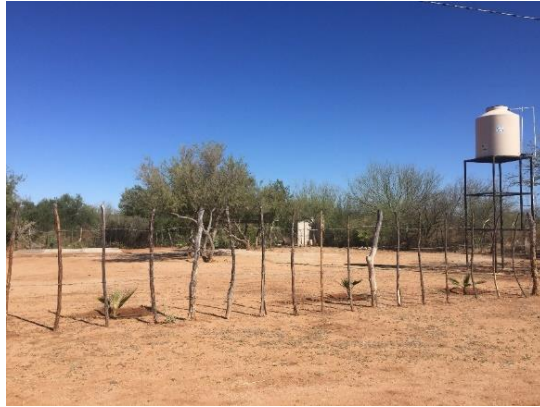
Figura 6.1 Instalación de tinaco y base metálica en lote baldío, localidad de Ures
